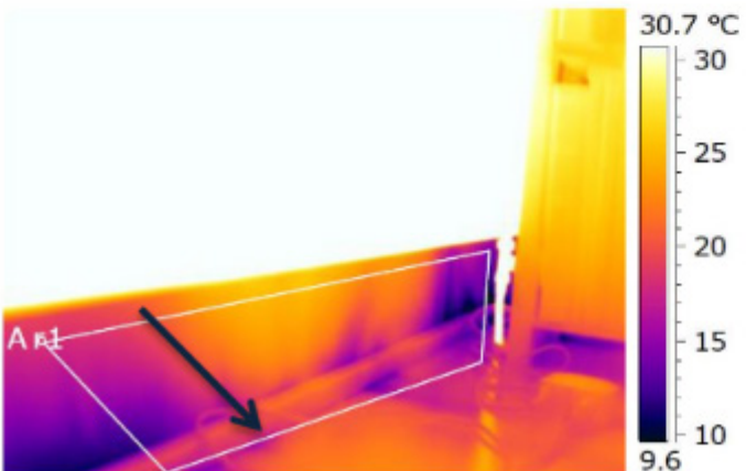
Skelagervej 83 Eksempel på kuldebro og træk i stue. Forundersøgelse udført: August 2015
