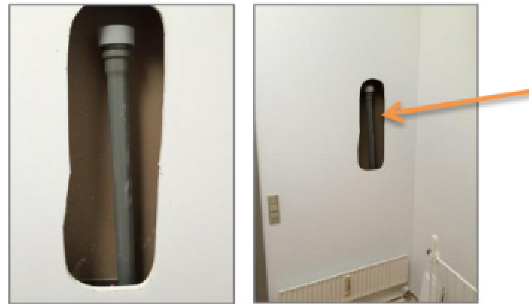
Hultagning i let væg ved badeværelse. Kloakudluftning er placeret og afsluttet midt i væggen.
