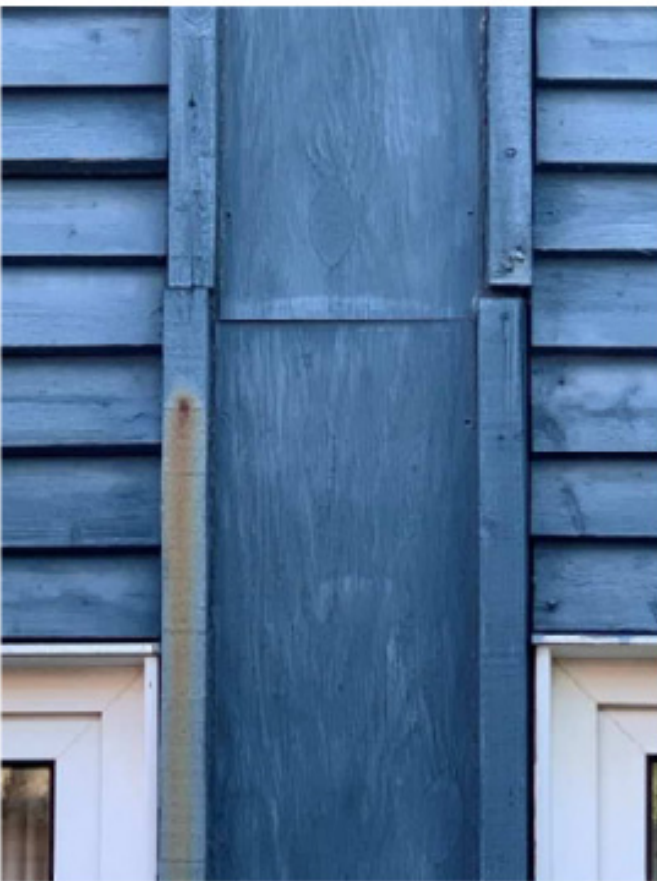
Krydsfiner er delamineret og under nedbrydning.
