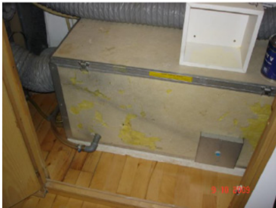
Ventilationsanlæg med flexslanger og afløbs-slange. Der er vandskader på gulv.
