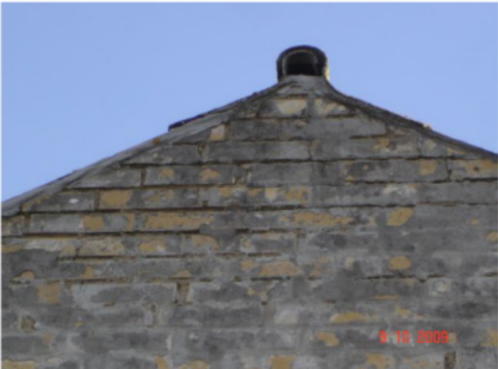
Kraftigt nedbrudt murværk øverst på gavl. Tagplader mangler fremspring i forhold til gavlmur.
