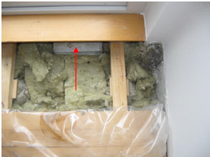
Sløset og mangelfuld isolering i nr. 255. Forundersøgelse udført: August 2010
