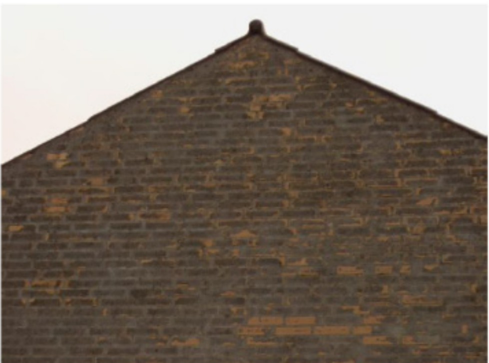
Opfugtet murværk, afskallet vandskuring og porøse fuger.
