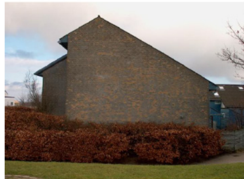
Gavl med opfugtet murværk
