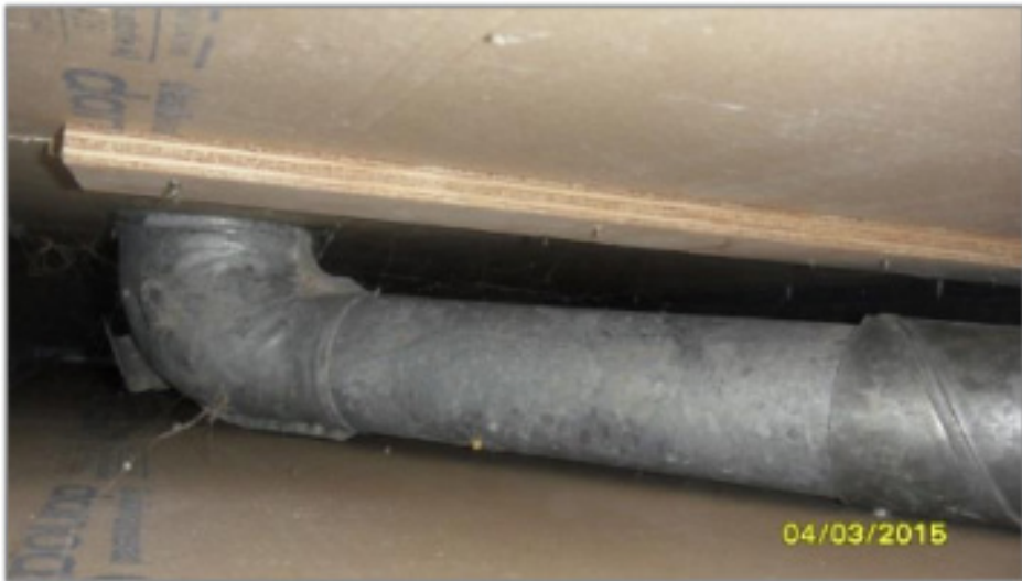
Hultagning i let væg ved badeværelse. Alt fremtræder tørt og uden skadessymptomer.
