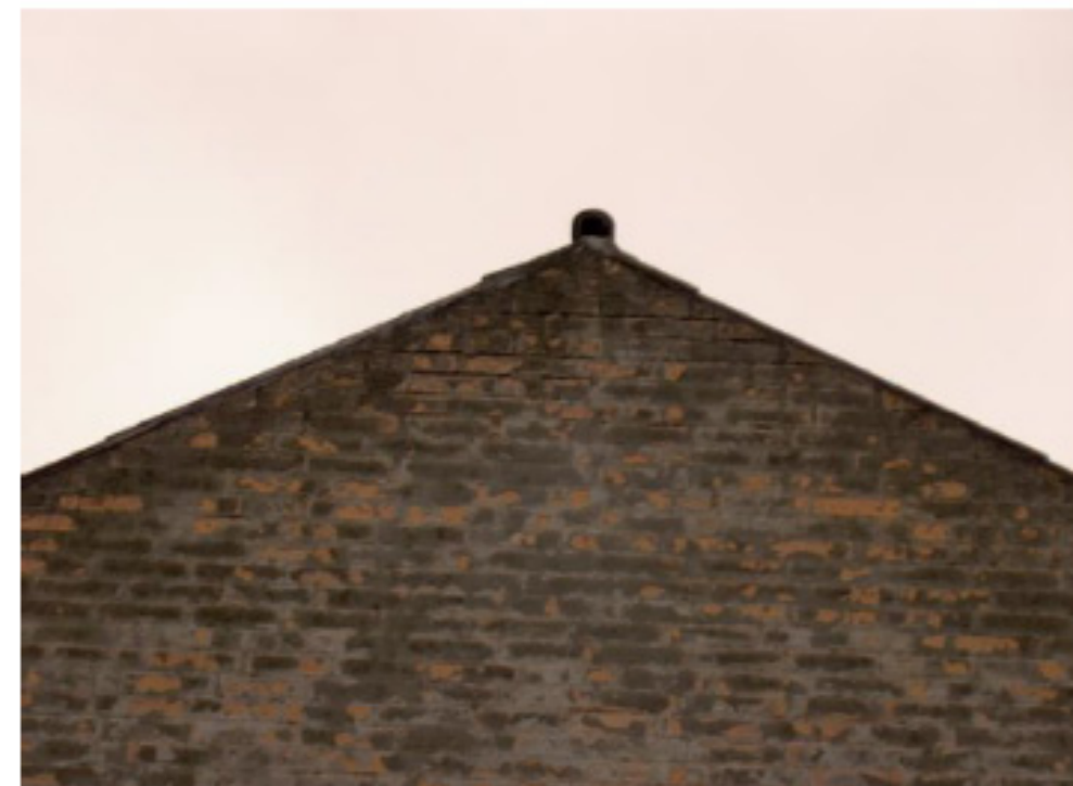
Opfugtet murværk, afskallet vandskuring samt defekte og udfaldne fuger.
